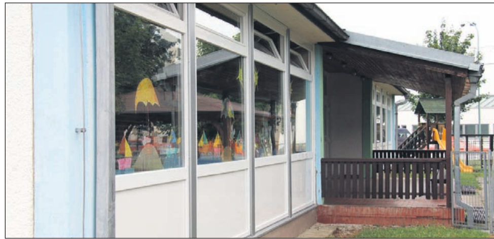
Na celotnem objektu vrtca Dornava so vgrajena nova okna, v treh igralnicah imajo na novo nameščene klimatske naprave.
