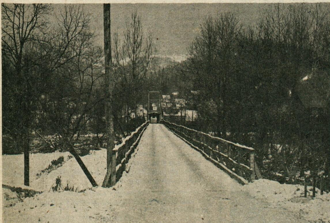
Most preko Save v Jevnici je še dober, podaljšek pa je popolnoma dotrajan, zato je prehod preko njega zaprt. (Foto: GO)
