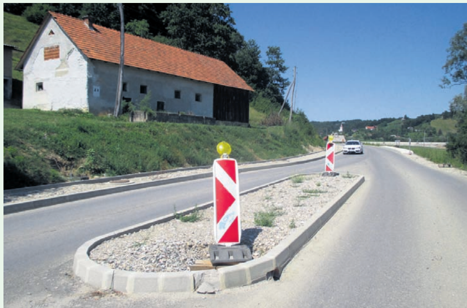
Prometni otok pri Novi cerkvi pri Podlehniku sploh še ni končan, pa so ga (domnevno prehitri) vozniki že poškodovali.
