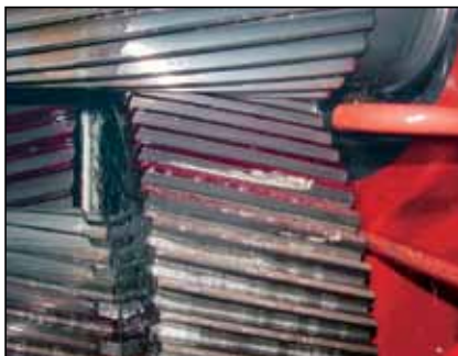
Slika 1. Poškodbe zobnikov reduktorja
