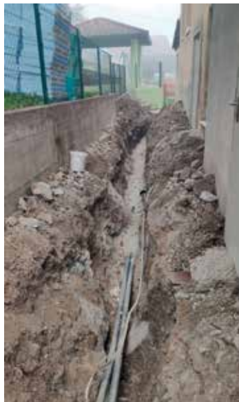
Povezava od vrtin do kotlovnice
