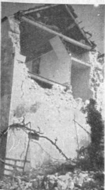
Ob prvem sunku so v Podgori hiše razpadle, nadaljnji potresi pa rušijo preostale razpokane in napol porušene zidove...
