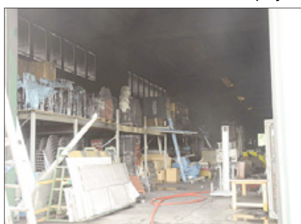
Počrnjena notranjost hale
