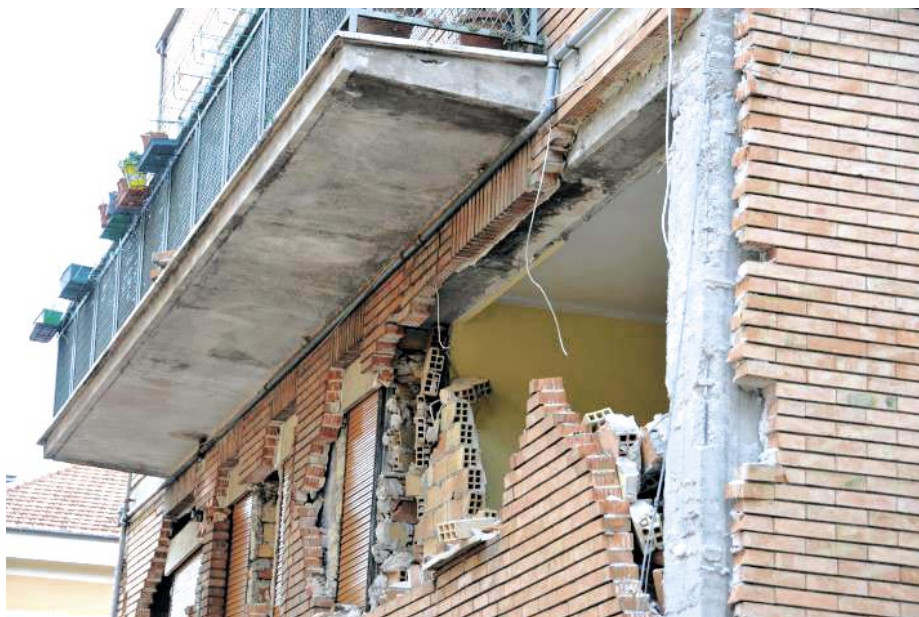
Slika 2 • Porušitev dvoslojne fasadne stene
