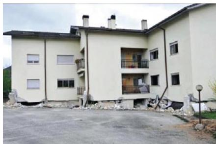
Slika 4a • Porušitev pritličja stanovanjskega bloka v Pettinu
