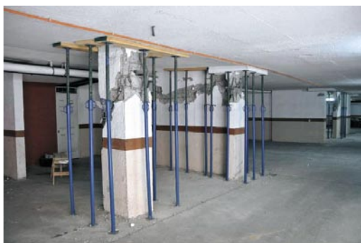
Slika 11 • Značilna porušitev sten v prvi kletni etaži
