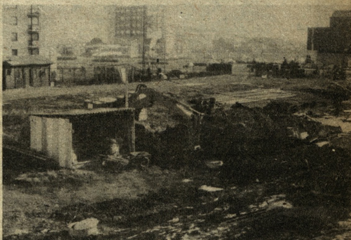
Pri gradnji novega zaklonišča in urejanju soseske ob gasilskem domu so delavci po nerodnosti presekali vodovodni priključek in telefonski kabel in tako je ostalo tudi naše uredništvo dva dni brez vode in telefonske povezave.
