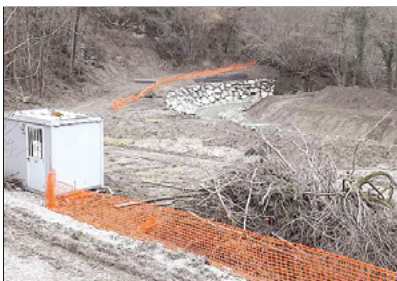
Pogled na razdejan naravni kotichek
