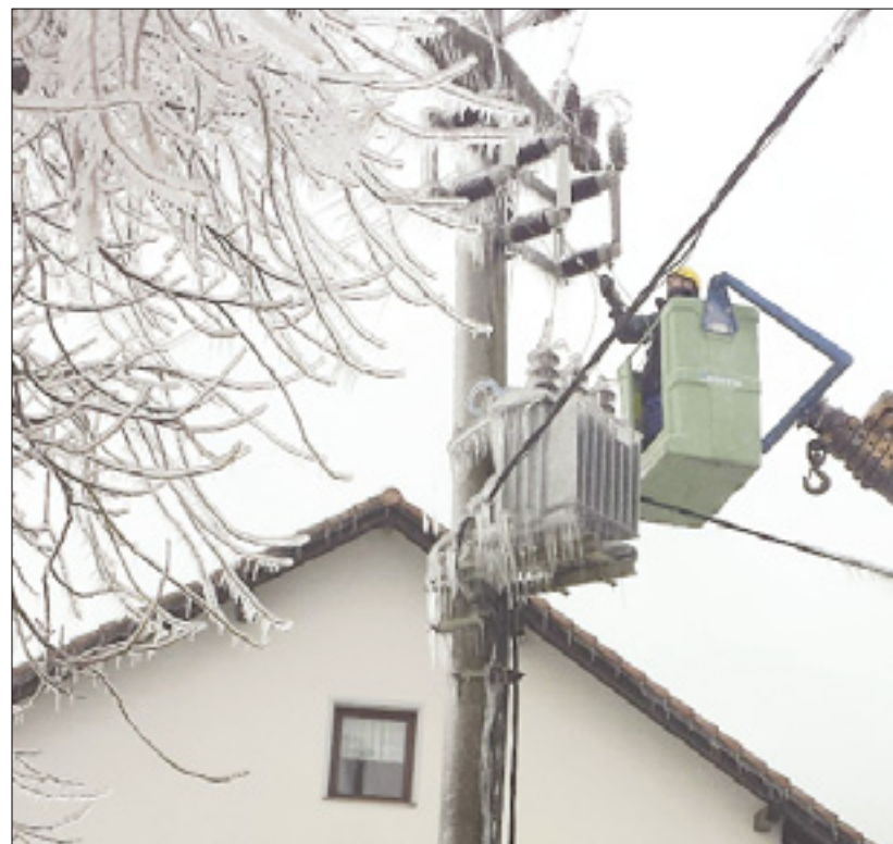
Delavci Elektro Primorske odpravljajo škodo na električnem omrežju
