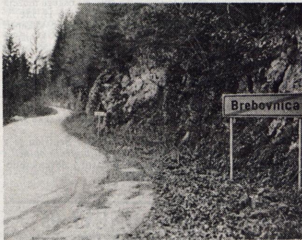
Asfalt-makadam-asfalt-makadam... Obljub naveličana regionalna cesta Gorenja vas - Lučine - Horjul.
