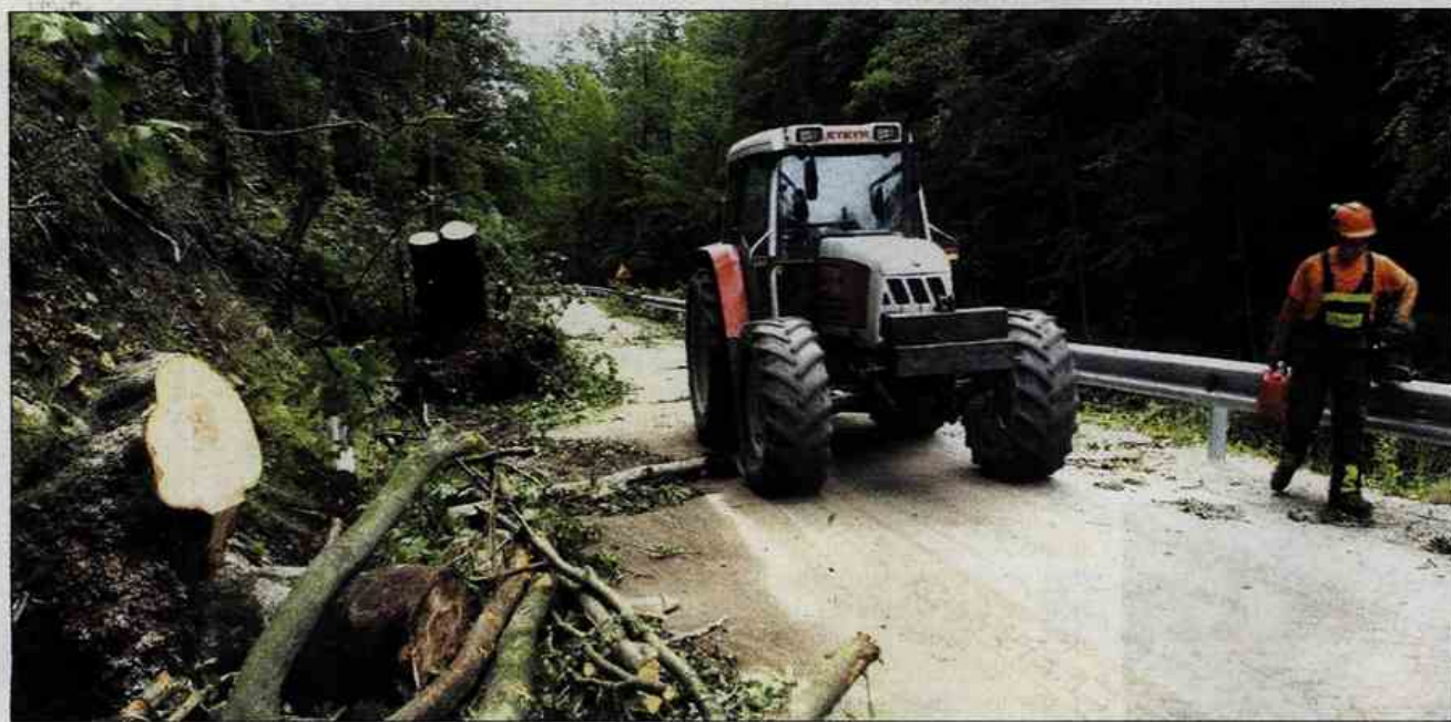
Gozdni delavci so imeli v torek ogromno dela, da so podrto drevje na cesti Jurklošter-Mrzlo Polje pospravili s ceste. Bolj zahtevno bo spravilo podrtega drevja v gozdu.
