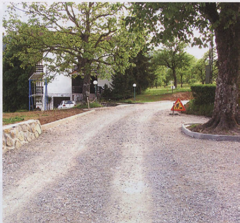
V Žlebeh so problem ceste. Cesto Koder - Cvajnar je potrebno le še preplastiti. / Foto: Petra Arhar
