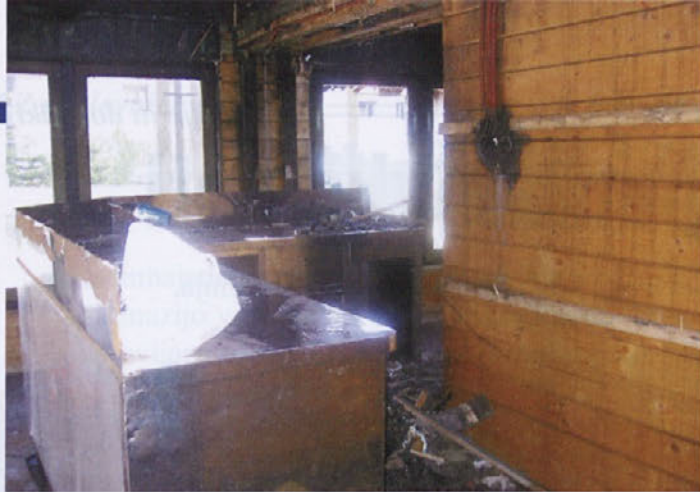
Lokal Pr' Peht: požar je uničil skoraj vse.
