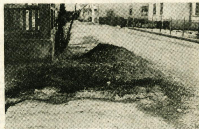
V Prešernovi ulici v Domžalah je bil pred hišo štev. 20 zgrajen požarno-varnostni vodnjak, ki je bil pokrit s kovinskim pokrovom. Pokrov je zaradi rje imel že velike luknje in je jama predstavljala nevarnost za mimoidoče, posebno ponoči. Namesto da bi popravili pokrov, pa smo vodnjak raje zasuli s premogovimi ugaski in s tem prihranili nekaj tisočakov. Ali je bilo to res pametno in ali se tudi gasilci, ki naj bi skrbeli za te vodnjake, strinjajo s tako rešitvijo?
