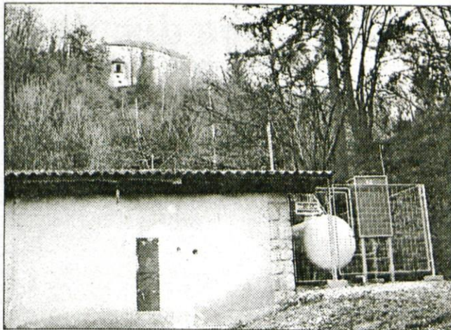
Plinska cisterna s prostornino 5000 litrov na spodnji postaji grajske žičnice, od katere je zgrajen plinovod na grad.
