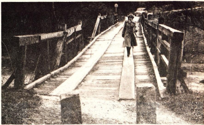
Dotrajan most — Leseni most čez Kokro, dokaj prometna povezava med Kranjem in Hujami, je tako močno načel zob časa, da je postal nevaren ne le za vozila, pač pa tudi za pešce. Zdaj je most zaprt za ves promet, toda pešci ga kljub majavi konstrukciji še pogumno prečkajo. — Foto: F. Perdan
