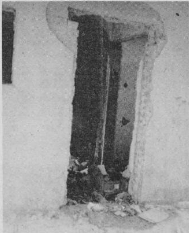
Pogled v notranjost je grozljiv
