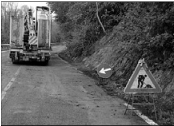
Odsek ceste, kjer se je vsul plaz
