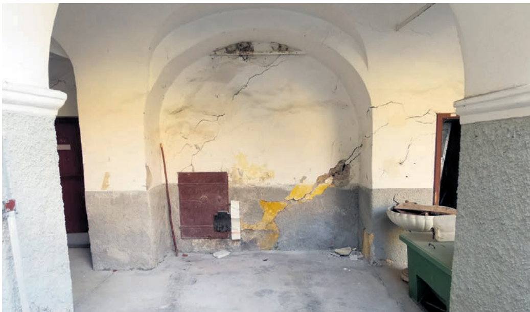
Pogled z dvorišča dvorca na poškodovano steno, kjer je poleg dodatnih razpok odpadel omet. Širjenje razpok na zunanji strani stene v prvem nadstropju dvorca pa je pokazalo, da se jugovzhodni del dvorca vedno bolj poseda. Po besedah statika velja, da se razpoke širijo pravokotno glede na posedanje.
