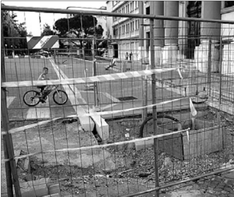
Ograjena »luknja« pred travniško cerkvijo
