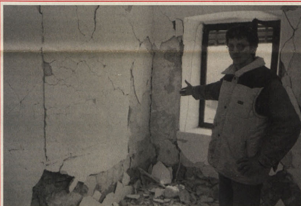
V Posočju se je na velikonočno nedeljo zatresto. Preko 700 ljudi je ostalo brez strehe, okrog 100 hiš bo treba porušiti. Stiska ljudi je velika.
