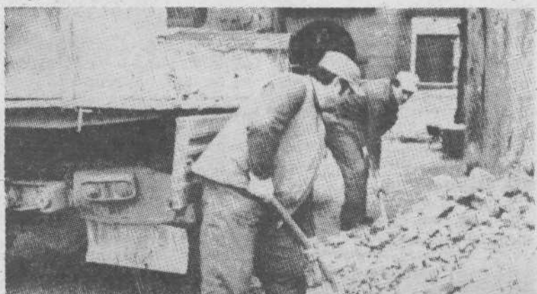
Prenovitev stanovanjske hiše Stari trg 6. Težave pri delu predstavlja tudi deponija. Naši delavci odvažajo star izkopan material s kamionom.
