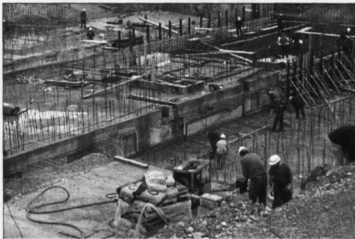
Delo na gradbišču je nevarno, a nesreč do sedaj na srečo ni bilo.
