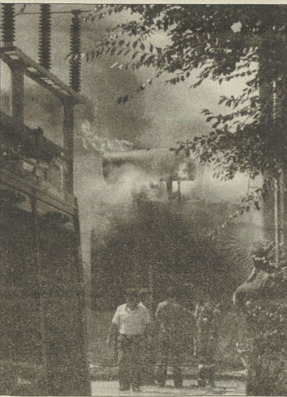
Ognjeni zublji so švigali in gost črn dim se je valil iz transformatorja električne centrale cementarne (f.Balbi)
