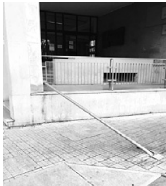
Zbit drog in poškodovan pločnik pred zavodom Slataper
