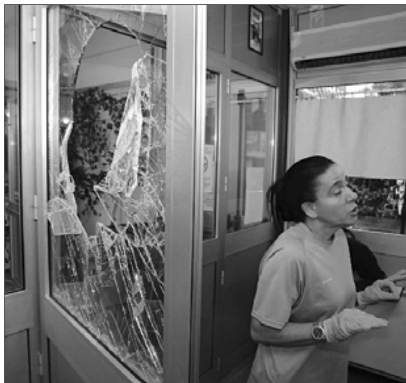
Vandali so v bazenu povzročili 40.000 evrov škode
