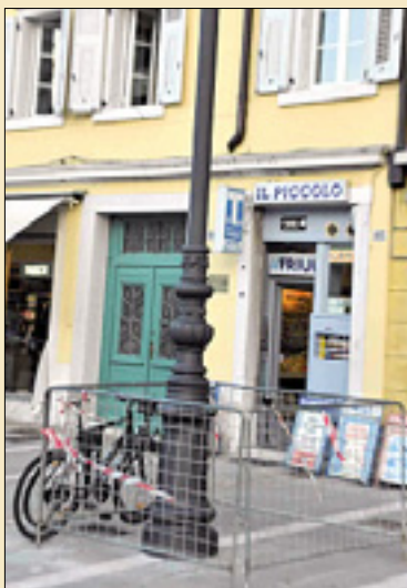
Poškodovani drog javne razsvetljave
