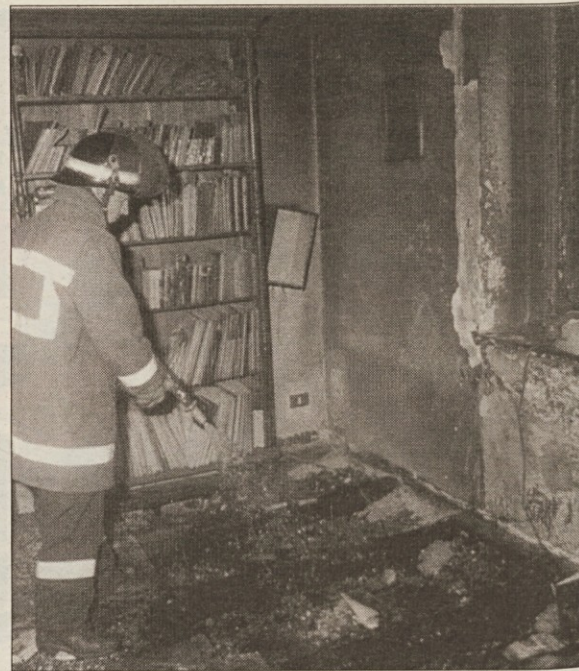
Ogenj je uničil pod in del pohištva (foto Bumbaca)
