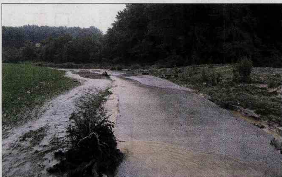
Vodotoki so poplavlili ceste, uničevali bankine in povzročali plazove. Posnetek je iz okolice Rogaške Slatine.
