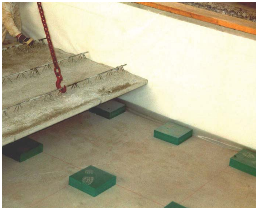
Slika 5: Značilna točkovna vgradnja protivibracijske izolacije
