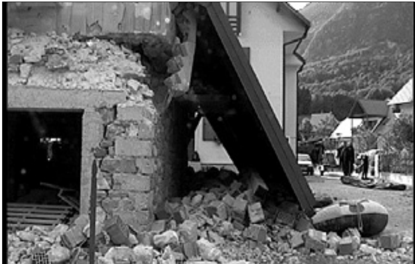
Potres leta 2004, »dokončal delo« potresa leta 1998
