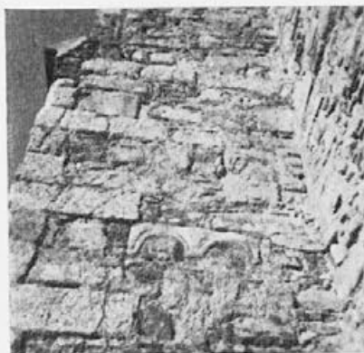
Sl. 6. Del romanskega ločnega venca vzdani v oporniku fasade mariborske stolnice.
