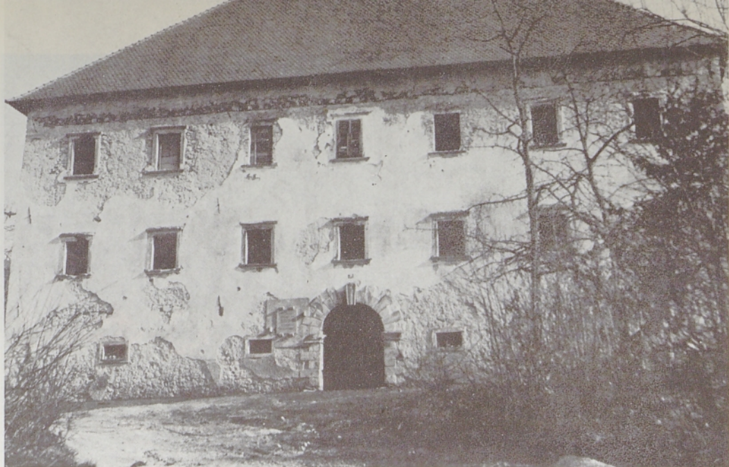
Grad Prežek — nekoč tako lepa stavba, danes kljub nekaterim zaščitnim delom propada
