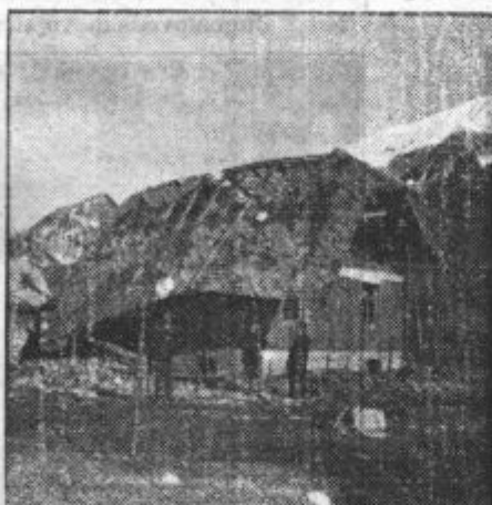
Porušena Pinova hiša na Selu.
