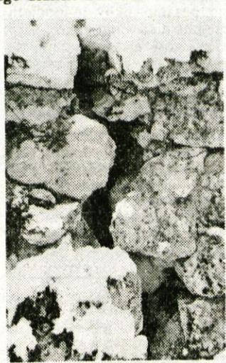
Največja razpoka zija v sredini opornega zidu na plaz.
