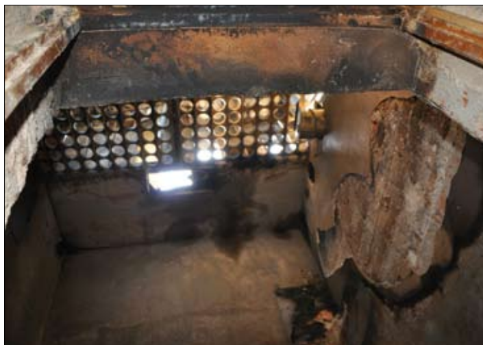
Uničen silos, foto: Uroš Gačnik
