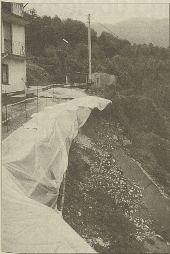
V zaselku Domenis v Ruoncu je cesta neprehodna (foto DU)
