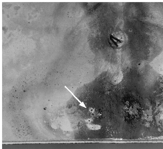
Sl. 2. Korozijske jamice na notranji površini cevi
