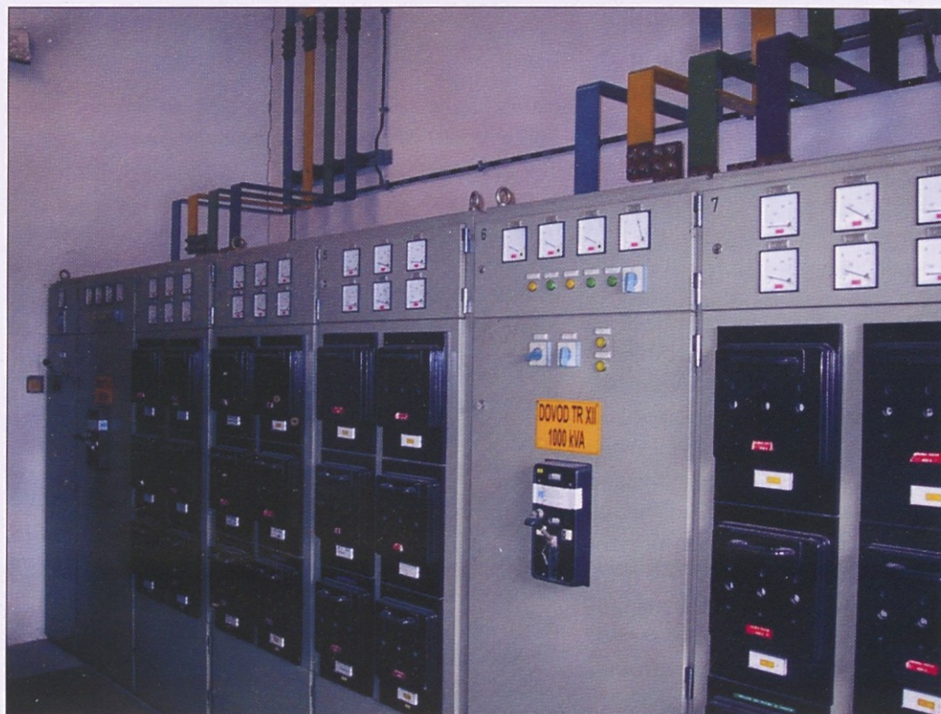
Del trafo postaje
