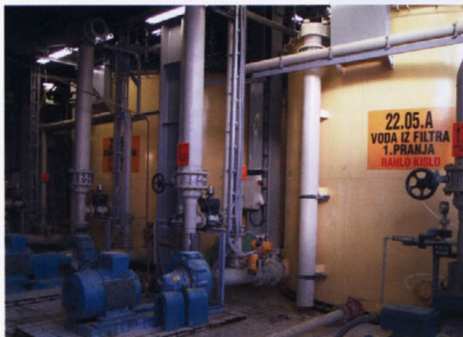
Skladiščne kadi za vodo s črpalkami, ki dajejo tudi preko 350 m 3 /h
