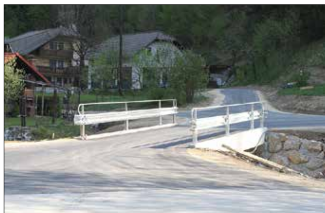
Nov betonski most z asfaltno prevleko je zamenjal starega z jekleno konstrukcijo in lesenim povoznim delom.
