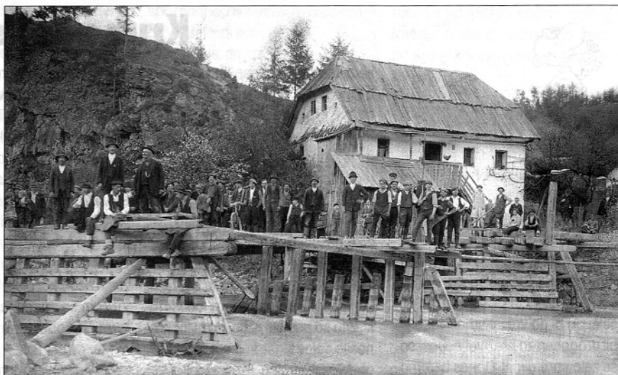
Gradnja mostu v Lučah. Prosimo naše bralce, da sporočijo, kdaj se je to dogajalo in kdo je vodil dela. Sliko nam je poslal Ludvik Petek s Podveže.
