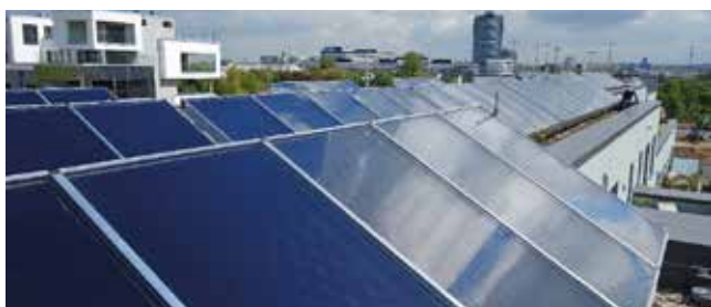
Sončni kolektorji so nameščeni na strehi stanovanjske stavbe v lasti stanovanjskega združenja (Rheinwohnungsbau GmbH) v Düsseldorfu v Nemčiji. (Vir: Solites)
