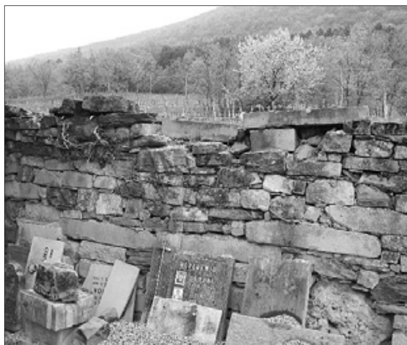
Razpadajoči zid na štmavskem pokopališču
