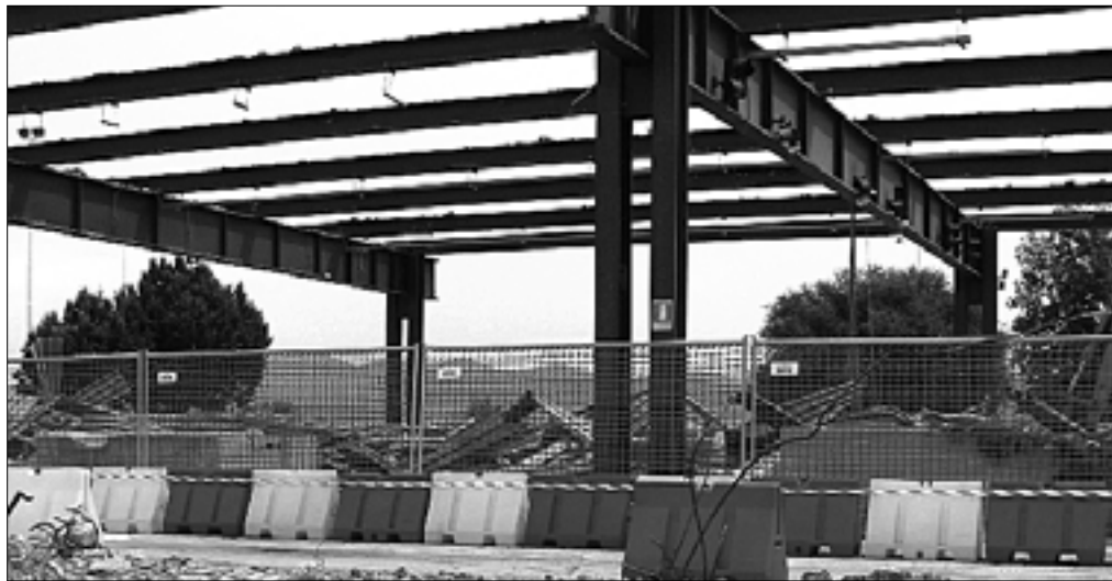
Že skorajda porušen nadstrešek na italijanski strani državne meje pri Štandrežu
