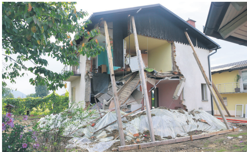
Hišo so morali po nasvetu gradbenega izvedenca dodatno podpreti. Tako naj bi bilo do porušitve. Foto: GrupA
