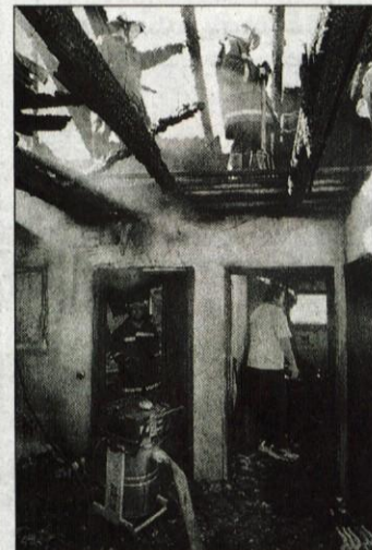
Mansardno stanovanje po požaru.
