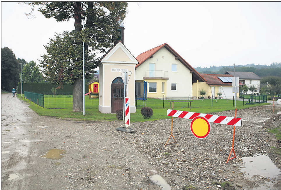
Do konca oktobra morajo v Podvincih grobo asfaltirati skoraj devet kilometrov po gradnji kanalizacije poškodovanih cest.
