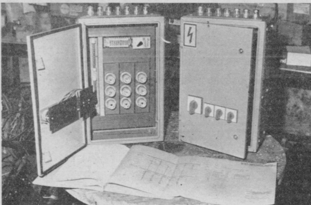
Razdelilci (razdelilne omarice v večjih zgradbah)
